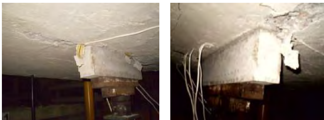
Figura 10: Observação do esmagamento do concreto da laje L4A
